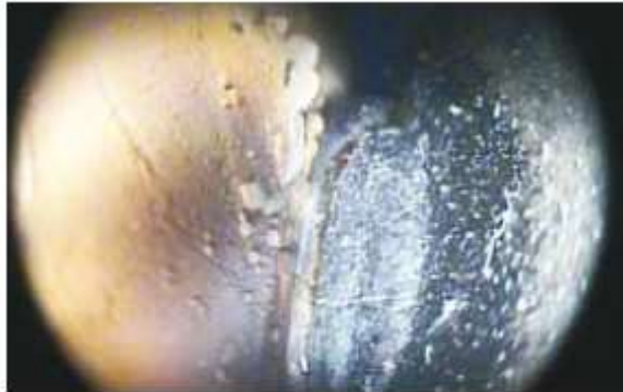
Détection de dépôts
