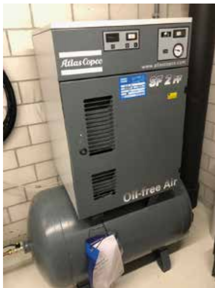
Figura 1 Monoblocco composto da essiccatore e compressore della ditta Atlas Copco. Sotto a questo monoblocco è possibile vedere il primo polmone di riserva dell'aria compressa 2 .
