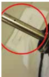
Korrosion am Versorgungsstecker
