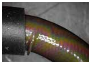
Verfärbungen am Einführungsteil
